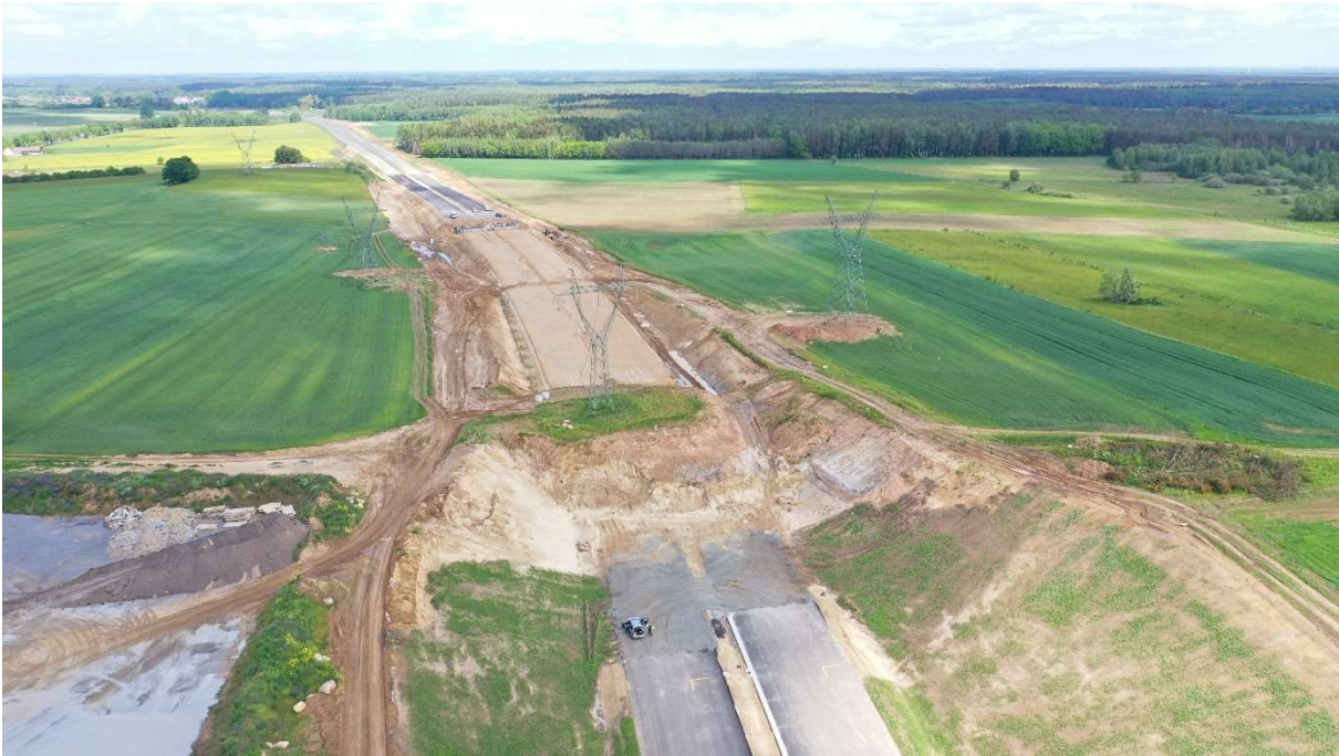
Rys. 3. Budowana droga ekspresowa kolidująca z linią 220 kV. Dla usunięcia kolizji konieczna jest przebudowa słupa.
